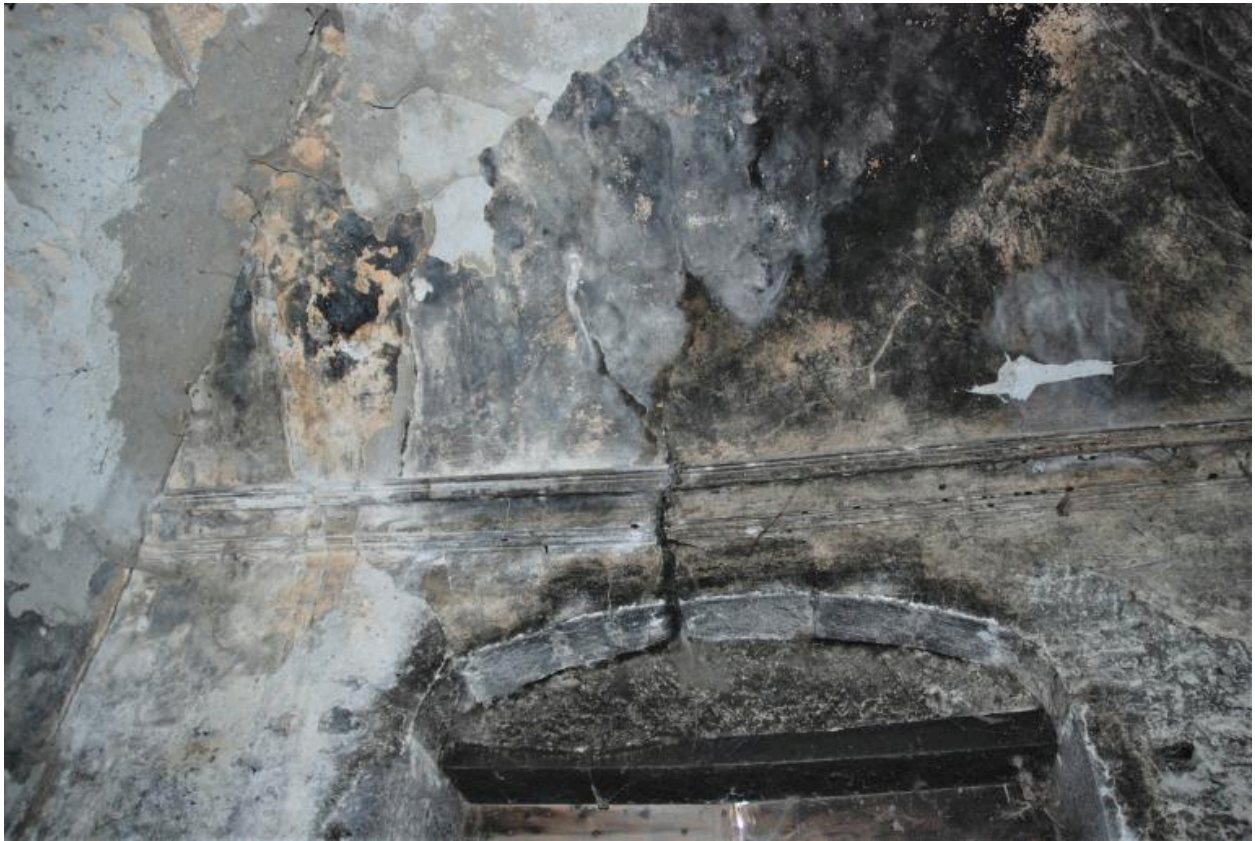
Ancienne chapelle de la demeure, détail intérieur du linteau du portail d'entrée.
