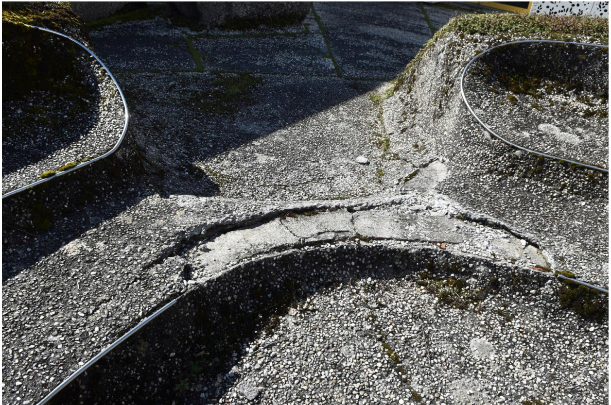
Détail des gradins : manques
