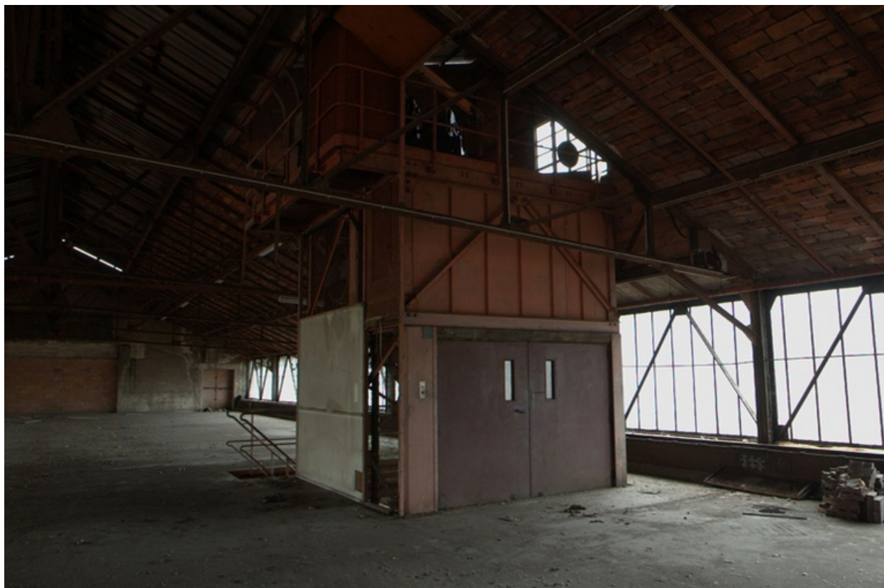
Monte-charge halle centrale
