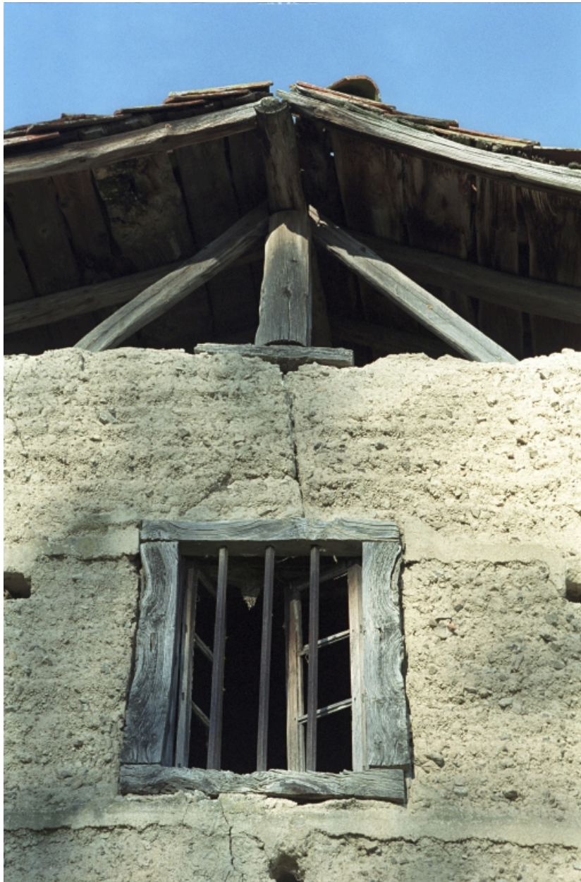
Saint-Sixte, Le Montcel (1987 B1 76 à 79). Lode de type E1a1. Détail de la charpente.
