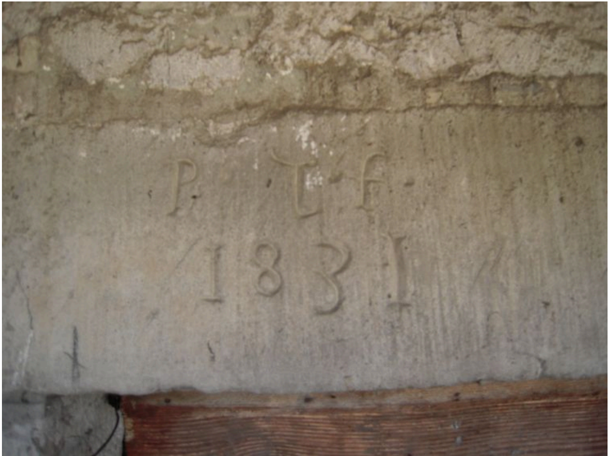
Vue de l'inscription du linteau gravé de la porte sur la façade nord.
