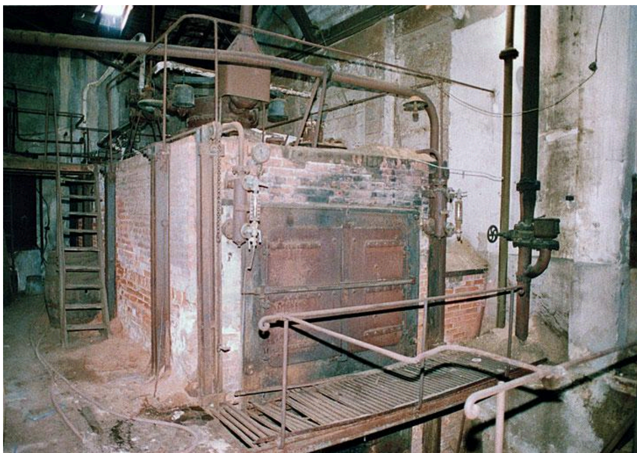
Chaudière de la machine à vapeur
