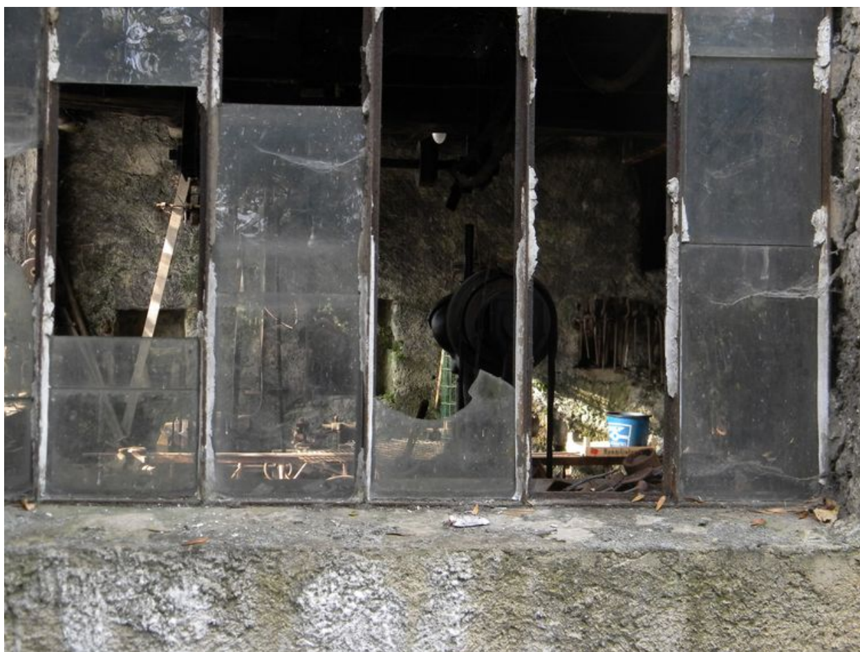
Vue de l'atelier à travers les vitres cassées depuis l'extérieur.
