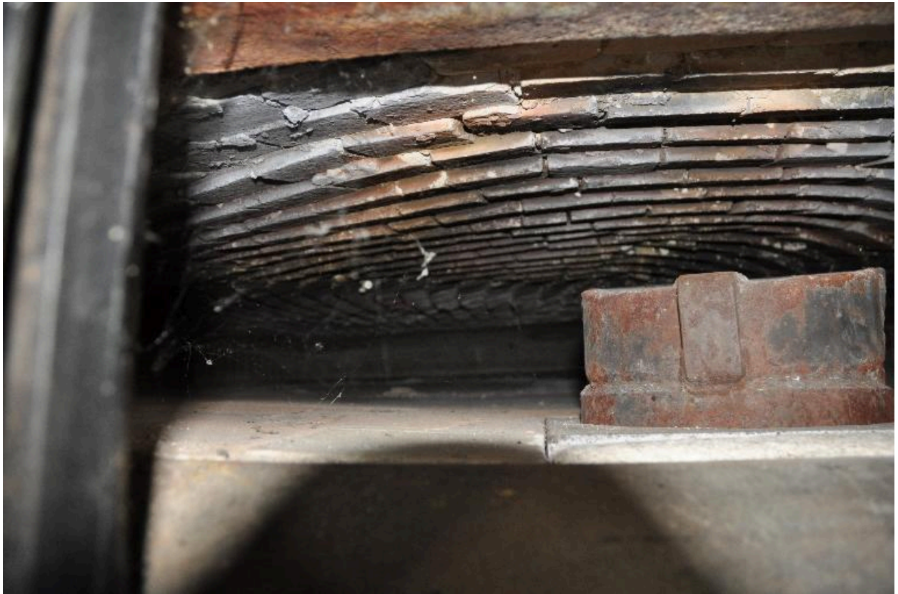
Vue intérieure du fournil : four à pain, vue intérieure de la chambre de cuisson.
