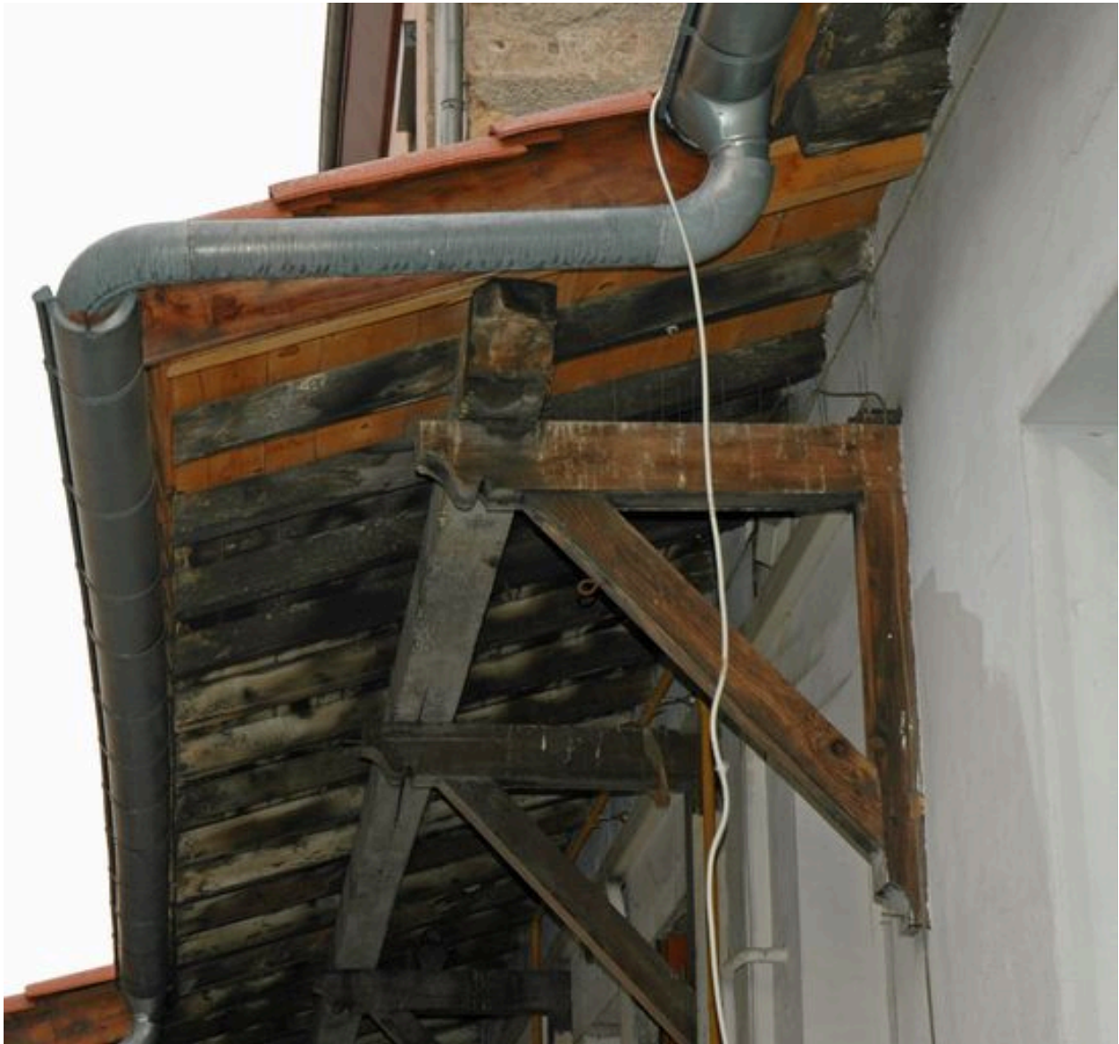
Détails d'aiseliers soutenant l'avant toit sur la façade ouest vue depuis le sud
