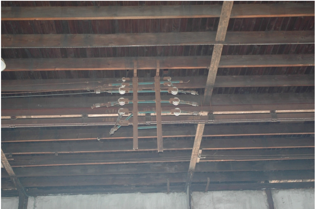
Détail circuit électrique
