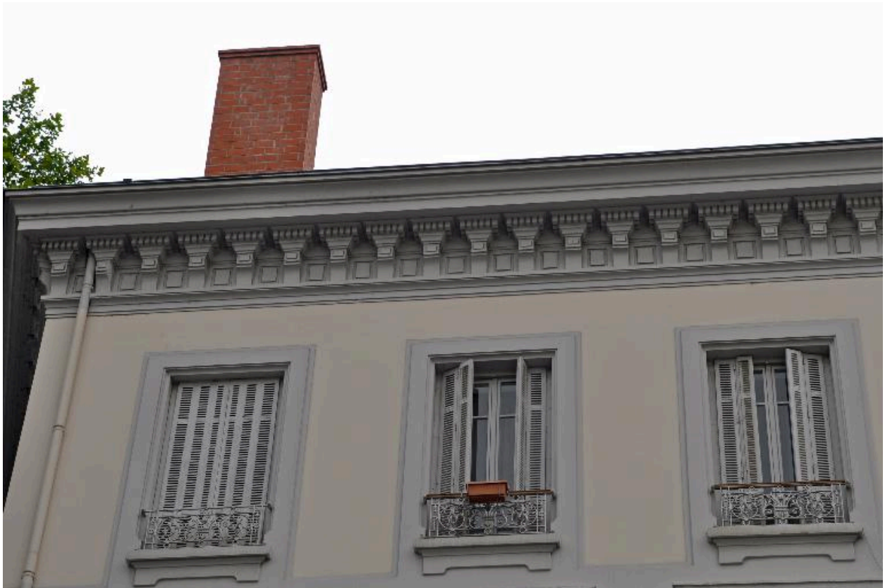
Élévation sur la rue du Père-Chevrier, détail du couronnement et de la corniche sculptée
