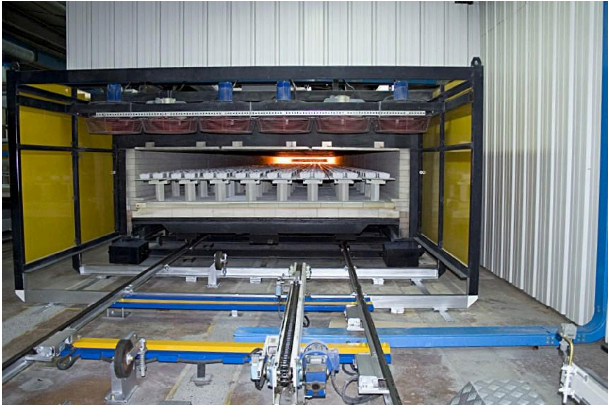
Vue du four tunnel
