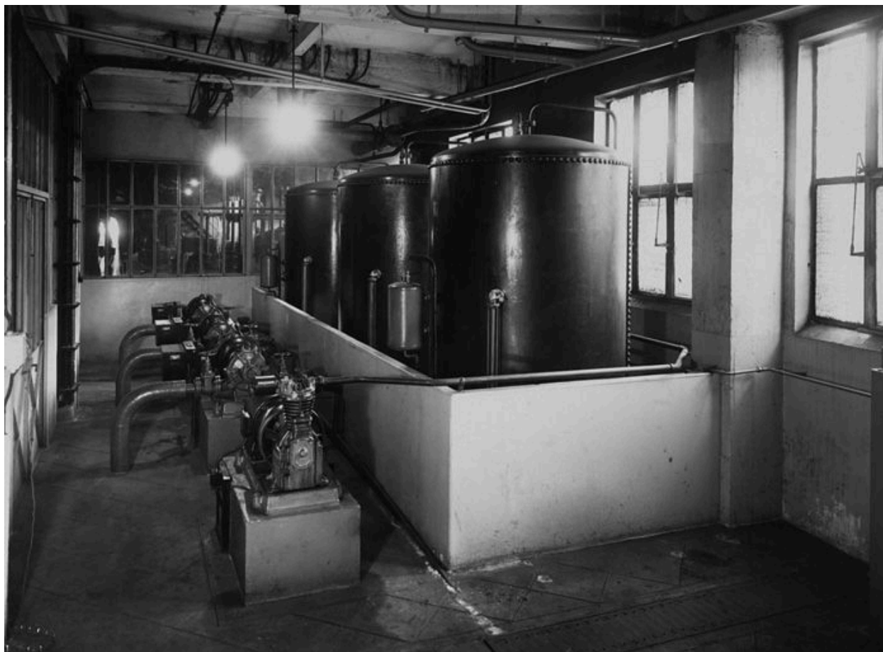
Station de surpression d'eau épurée pour le service sanitaire. Photogr., 3e quart 20e siècle
