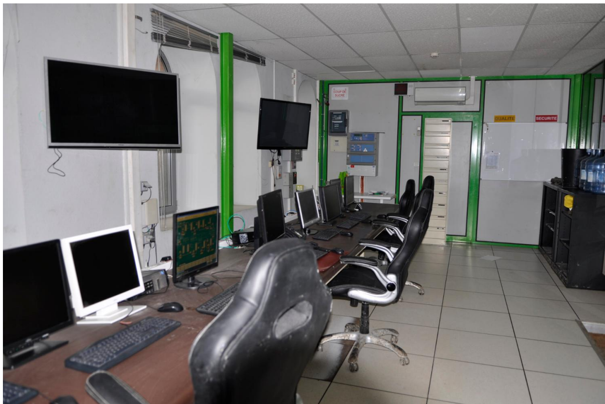
Vue intérieure salle de contrôle
