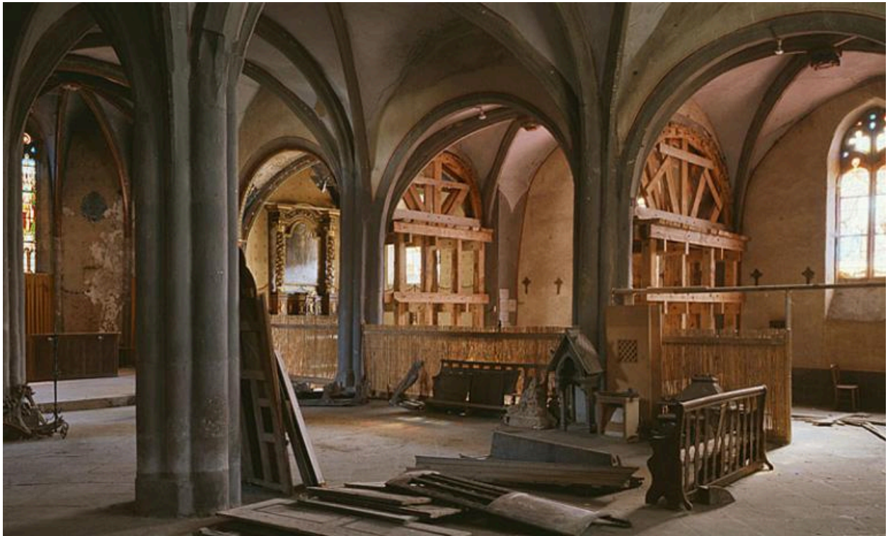
Le collatéral sud, vu de trois-quarts, en partie étayé pour prévenir son effondrement.
