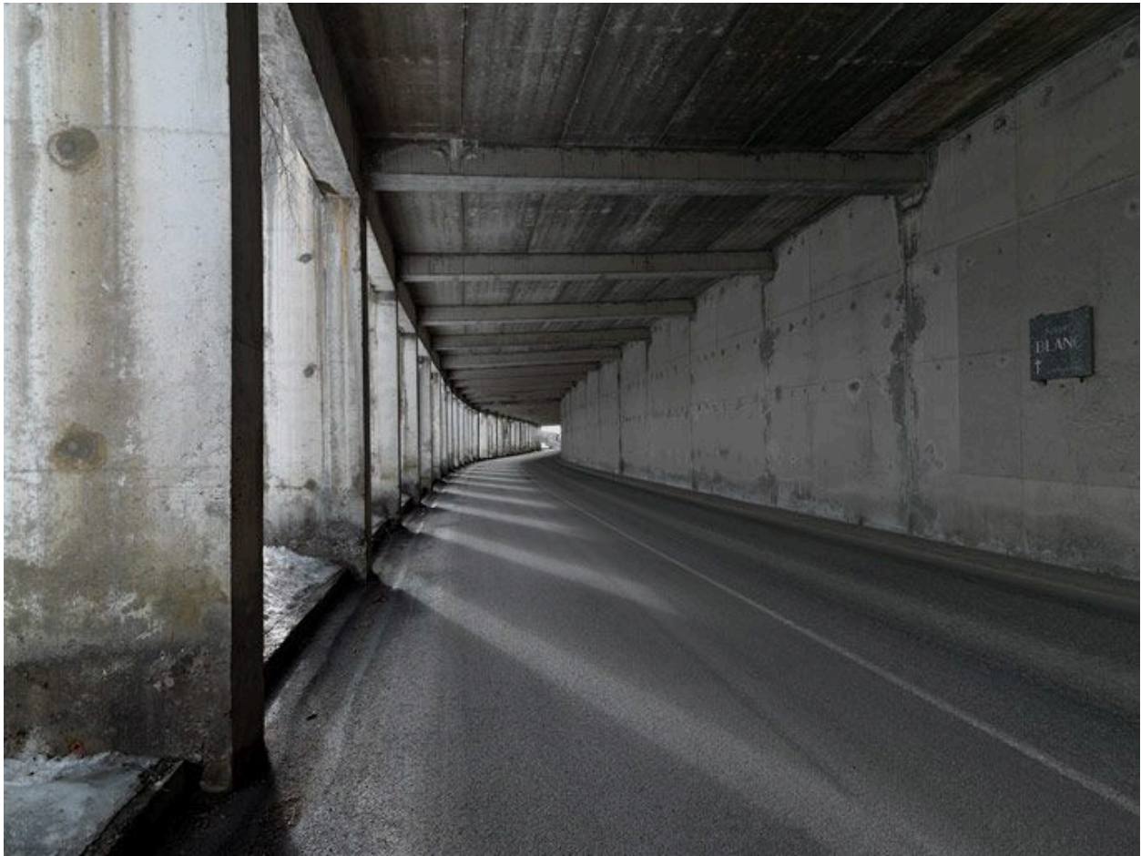
Paravalanche sur la route d'Arc 2000. Plaque à la mémoire de Robert Blanc
