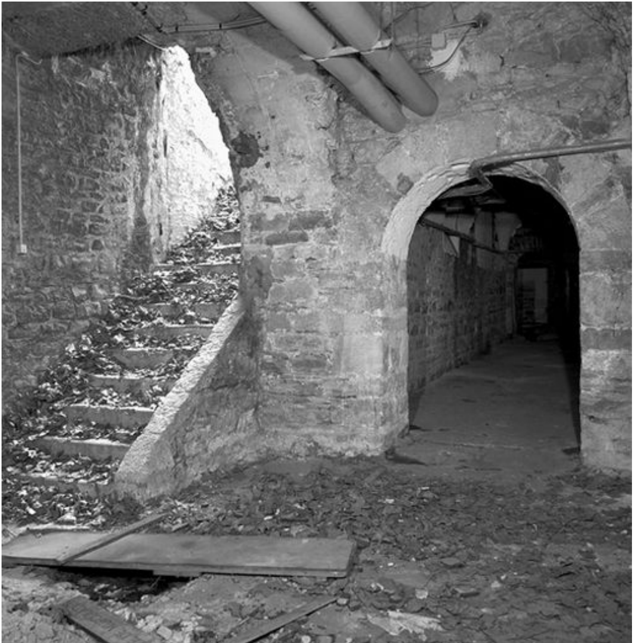
Sous-sol du bâtiment central, escalier et passage sous le corps de liaison sud-est
