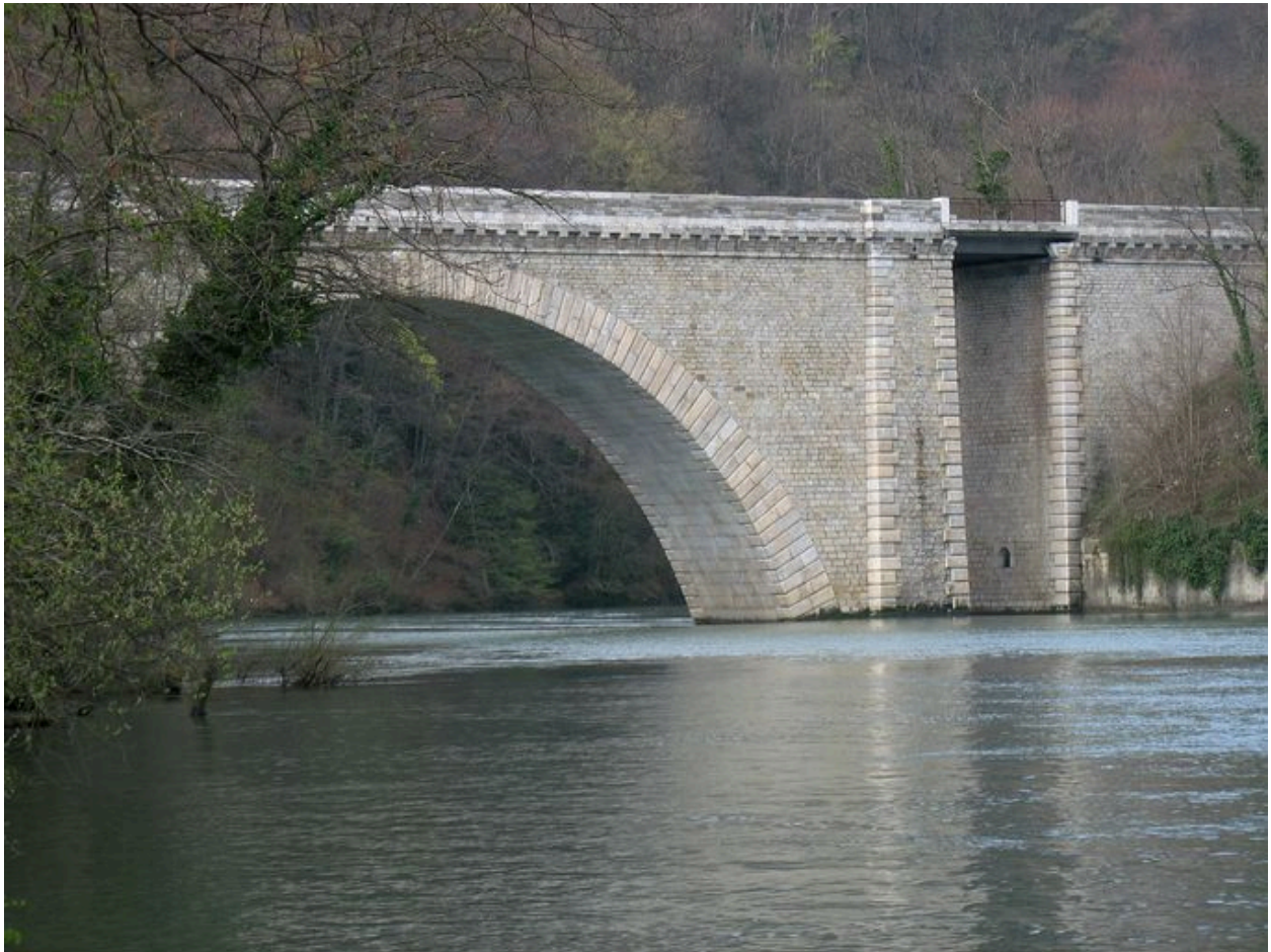
Vue partielle de l'arche, face amont, côté droit (depuis la rive gauche)
