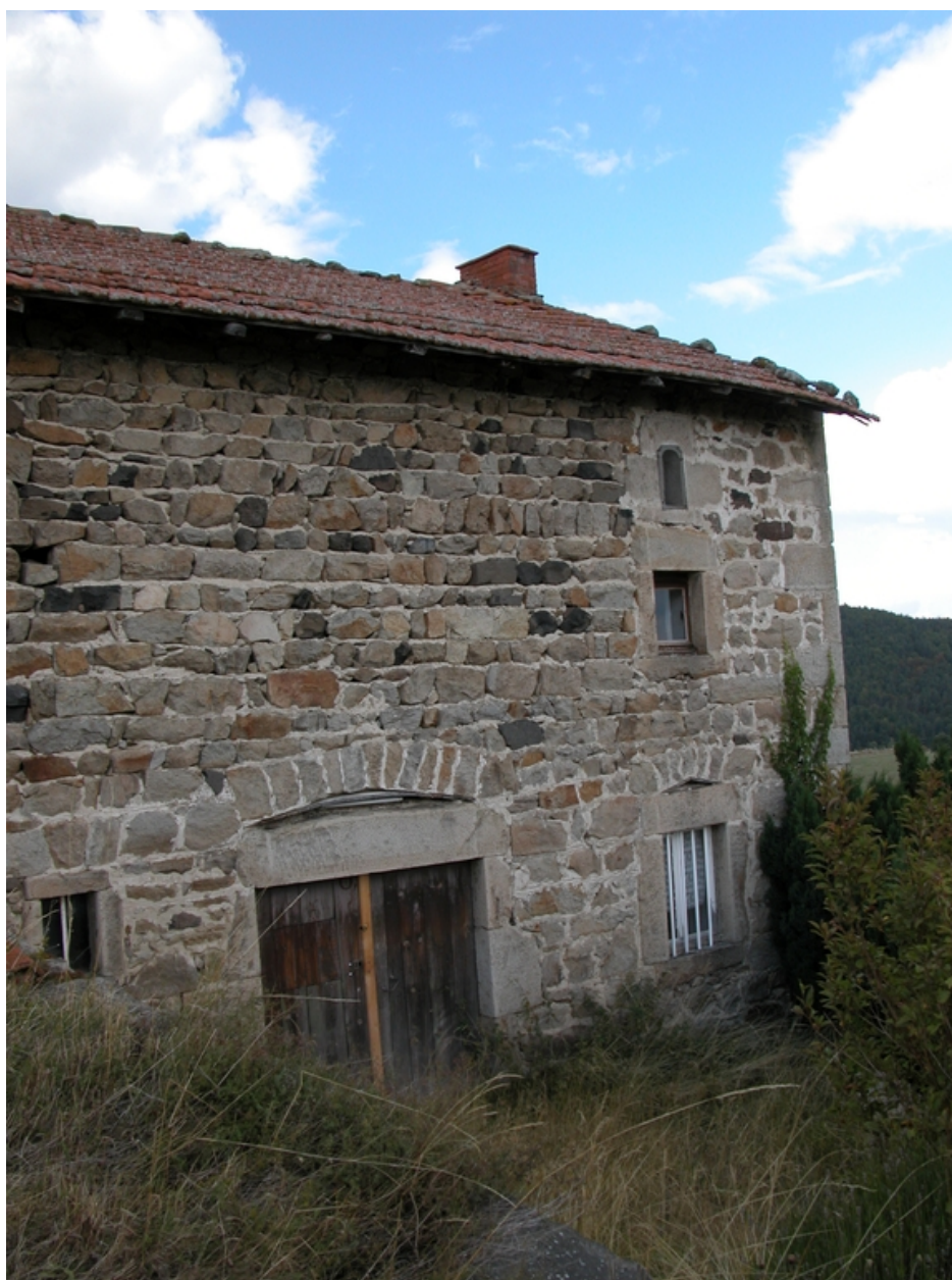
Vue latérale depuis le montoir.
