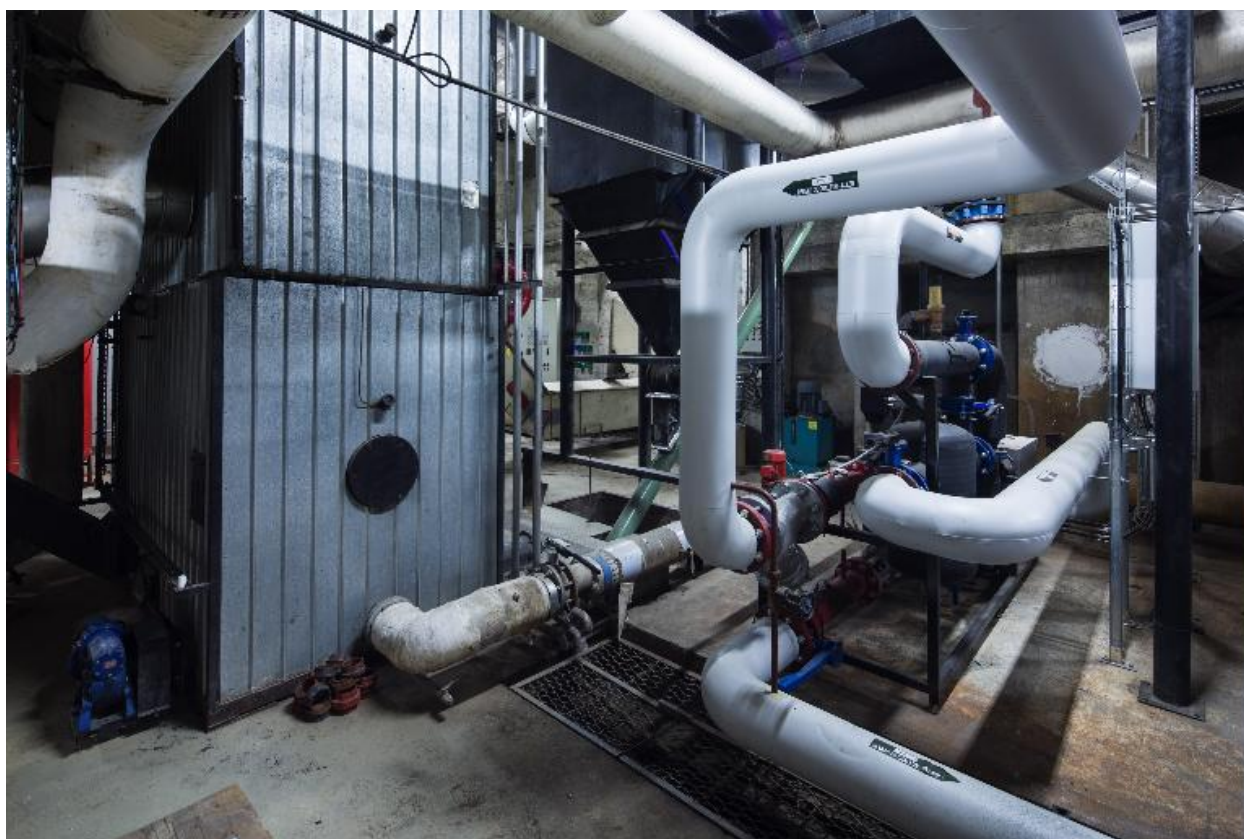
Bâtiment sud : chaufferie, ancienne chaudière bois
