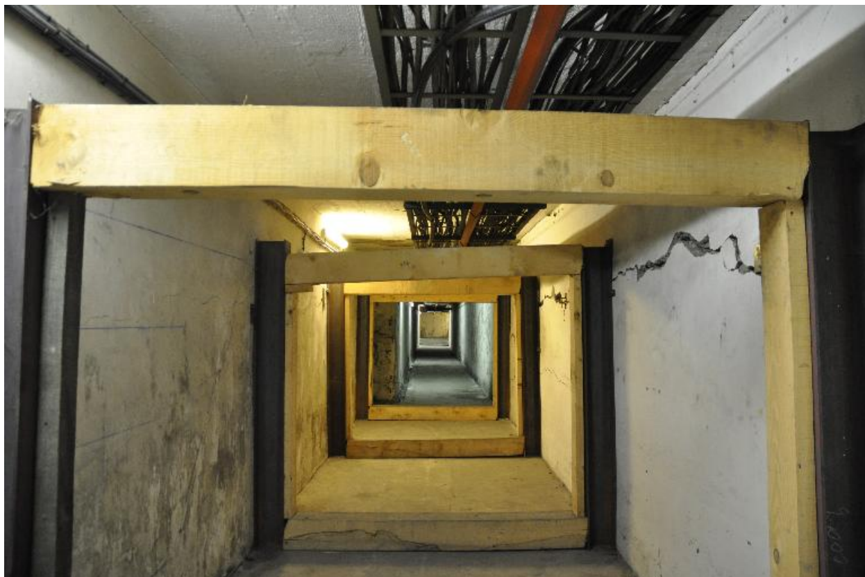
Vue d'une fissure et des étalements au sous-sol
