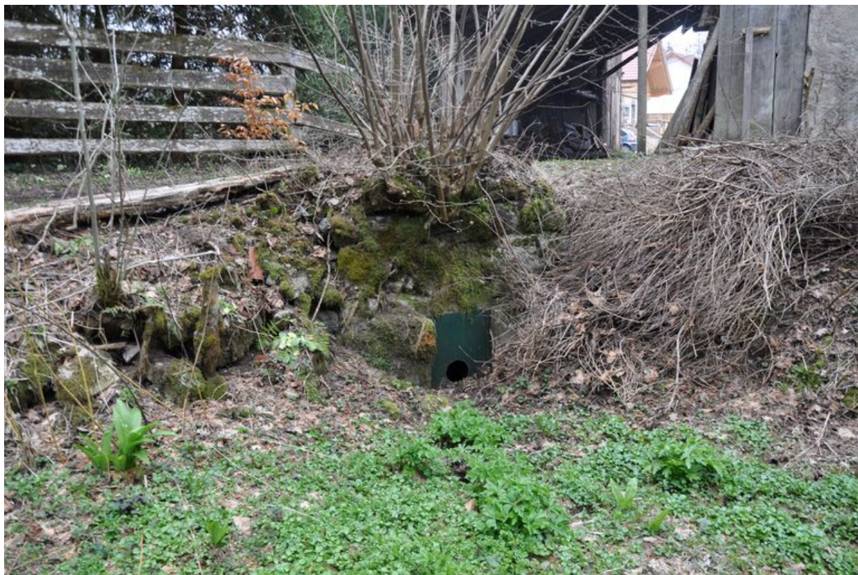
Détail de la prise d'eau d'un des deux bassins de retenue
