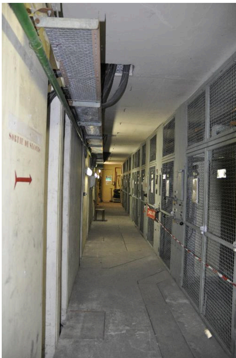
Vue de la salle des armoires de transformateurs
