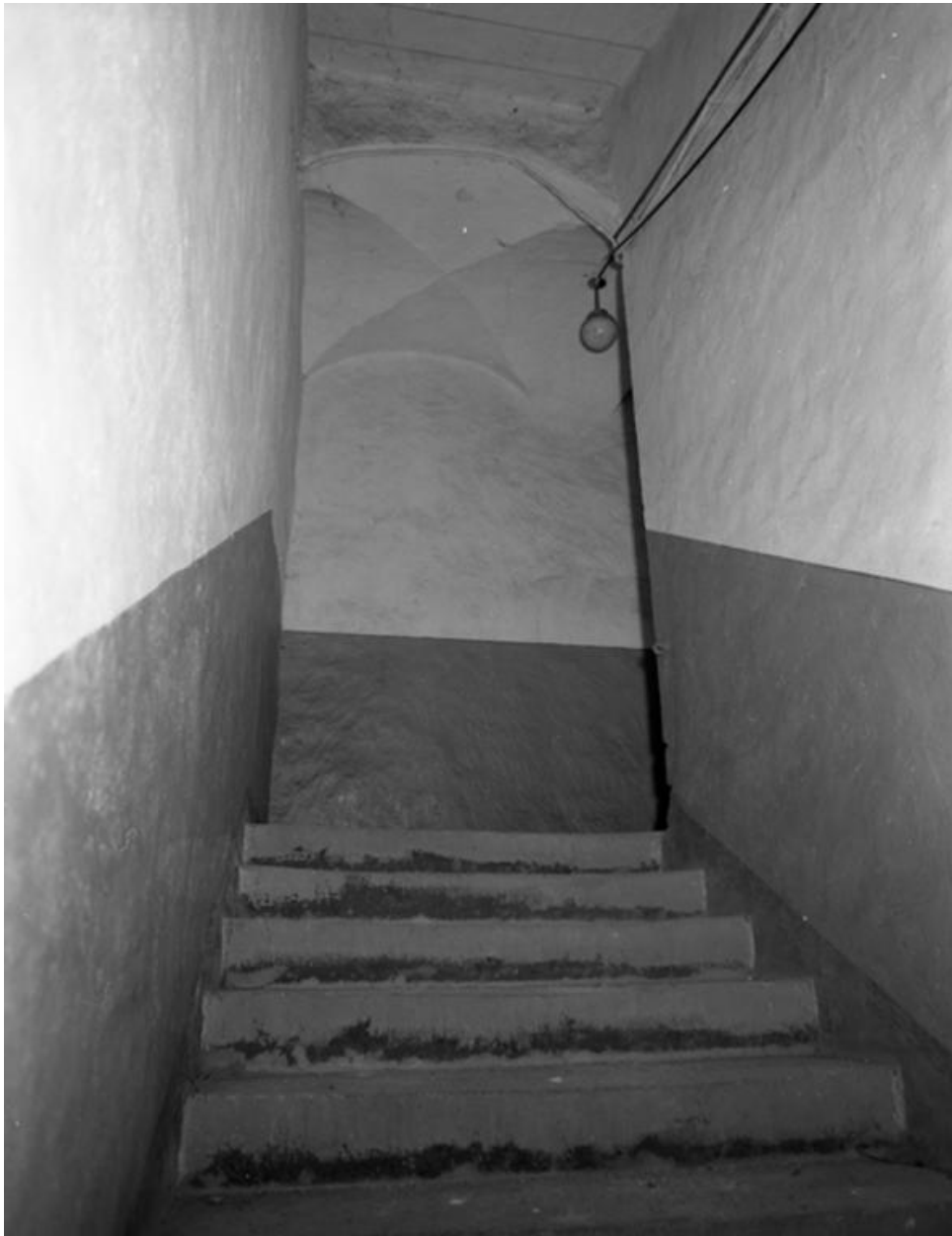
L'escalier et un palier intermédiaire voûté d'arêtes, entre le 2e et le 1er étage de soubassement, préservés lors des travaux de 2008.
