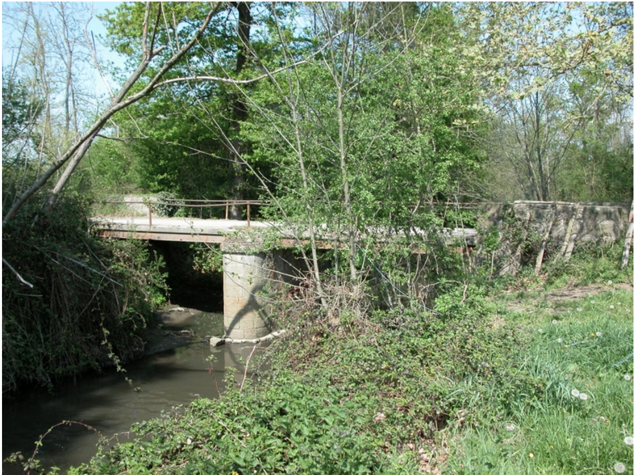
Vue du pont sur le Vizézy à Bullieu (1986 F non cadastré, vers F 17).
