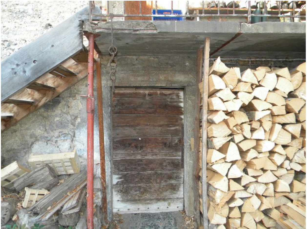
Entrée de cave sous la galerie de distribution du logis en rez-de-chaussée surélevé.
