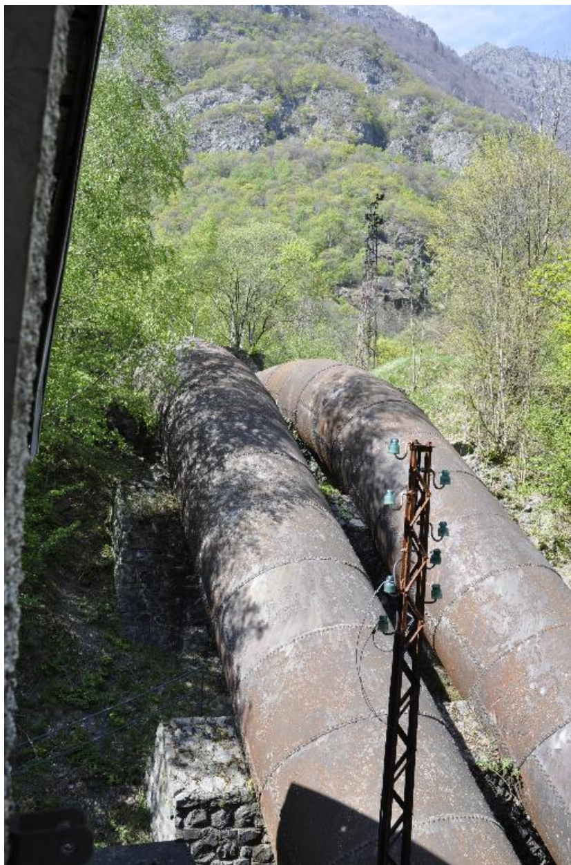
Vue d'une conduite forcée au niveau de la façade nord arrière
