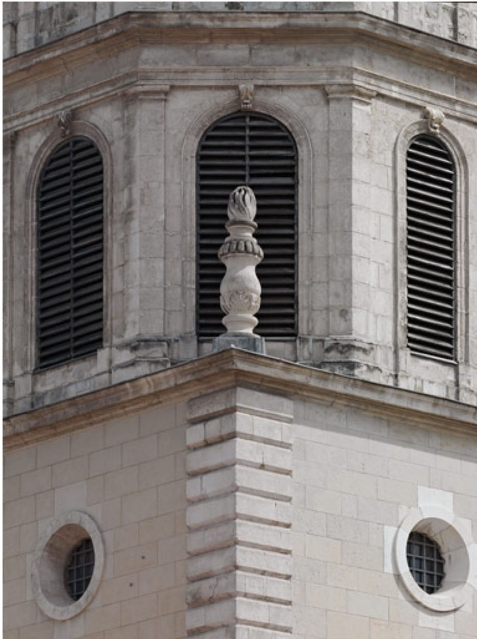
Clocher : vue de détail d'un pot-à-feu prise de la place Bellecour, depuis l'ouest, jonction entre la tour et la lanterne
