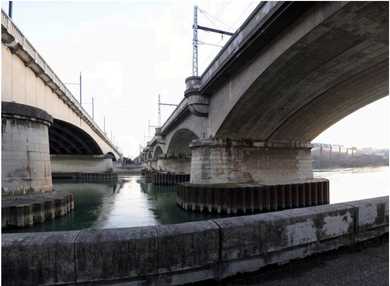
Vue générale, face amont, de côté (depuis la rive droite) ; le pont Poincaré sur la gauche
