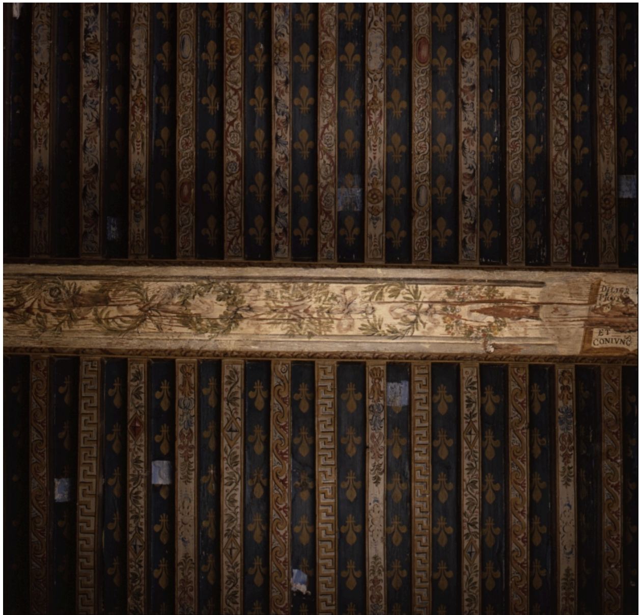
Poutre 5, face inférieure, centre gauche : couronnes végétales.
