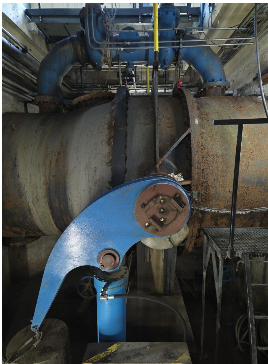
Détail vanne de pied
