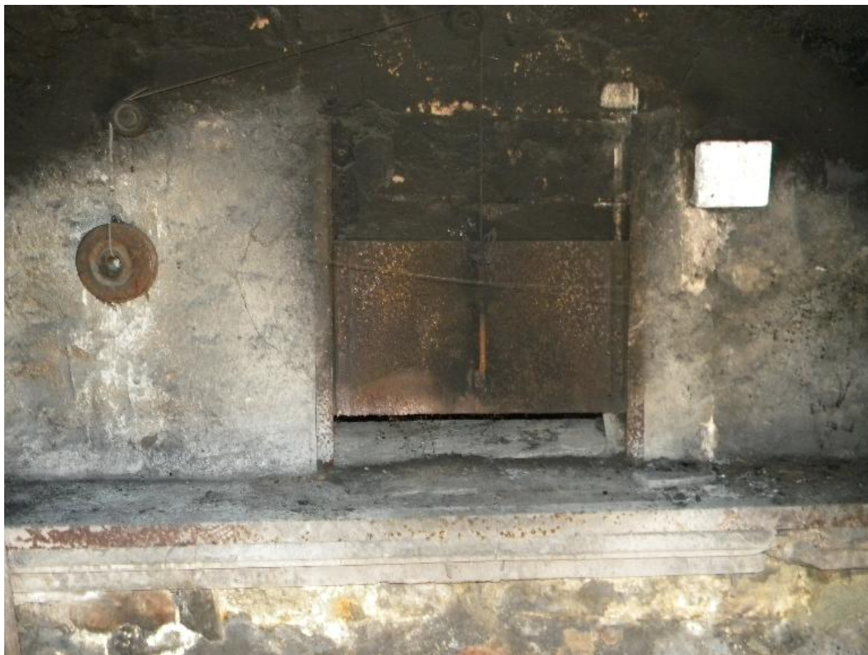
détail de la porte de la chambre de cuisson.
