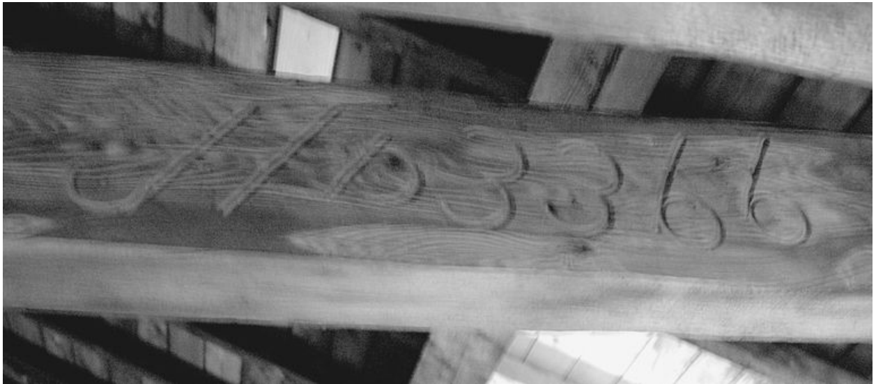
Bâtiment de la galerie, combles, détail d'une inscription sur une poutre, côté ouest
