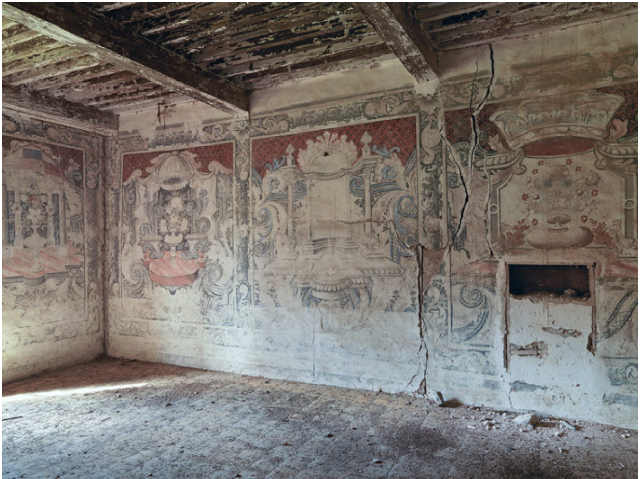
Angle nord-ouest : vue du panneau à droite de la fenêtre et des trois panneaux du mur nord.
