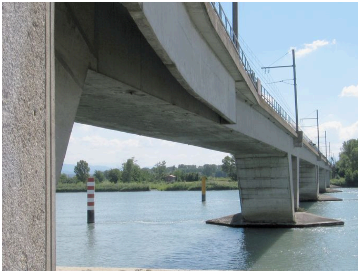
Vue du pont ferroviaire de La Voulte-sur-Rhône (Ardèche), depuis la rive droite ; pont à poutre à travées continues (1955)
