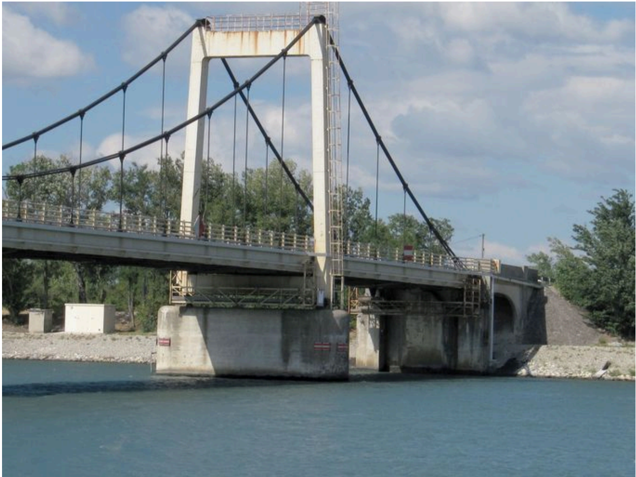
Travée et pylône de rive droite, face amont (depuis la rive gauche)
