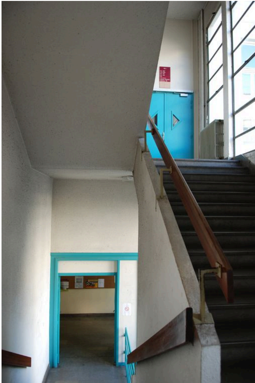
Bâtiment ISARA (2nd tranche), escalier, paliers du rez-de-chaussée et du 1er étage.
