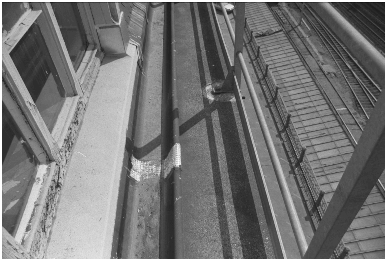
Détérioration légère des huisseries basses en chêne. Bâtiment F, 3e étage, façade ouest
