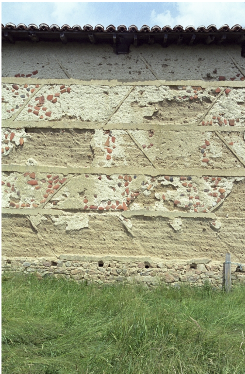
Bussy-Albieux, Les Beudents, ferme (1987 A1 295). Enduit chargé de tuiles.
