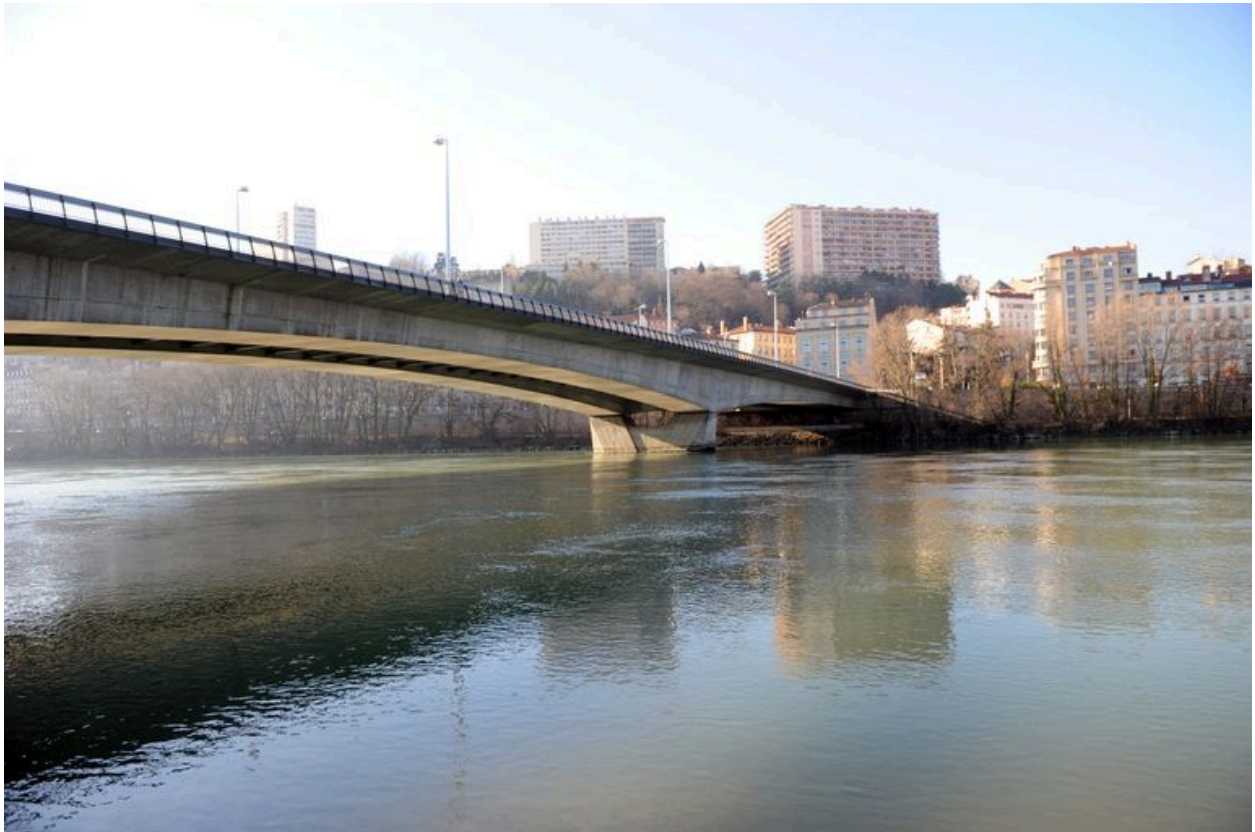
Vue partielle, de côté, travées centrale et droite, face amont (depuis la rive gauche)
