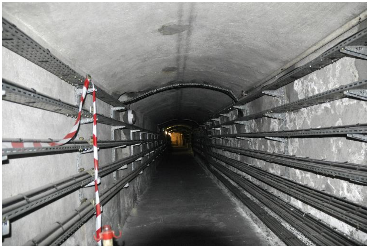
Vue du sous-sol de la centrale
