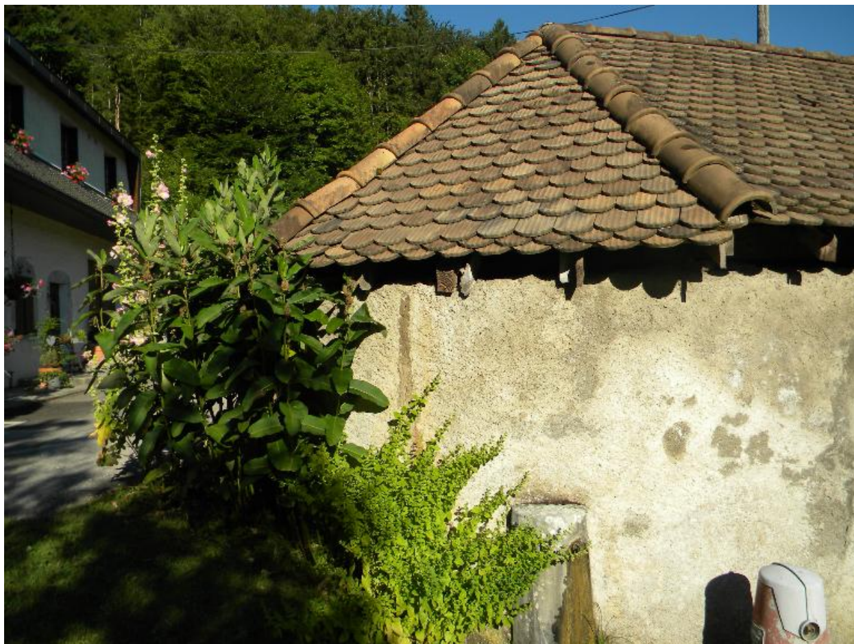
Vue de l'arrière du four.
