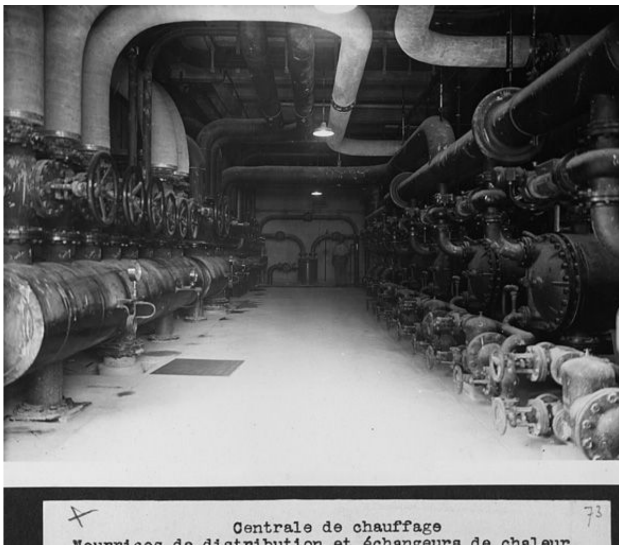
Centrale de chauffage. Nourrices de distribution et échangeurs de chaleur. Photogr., vers 1960
