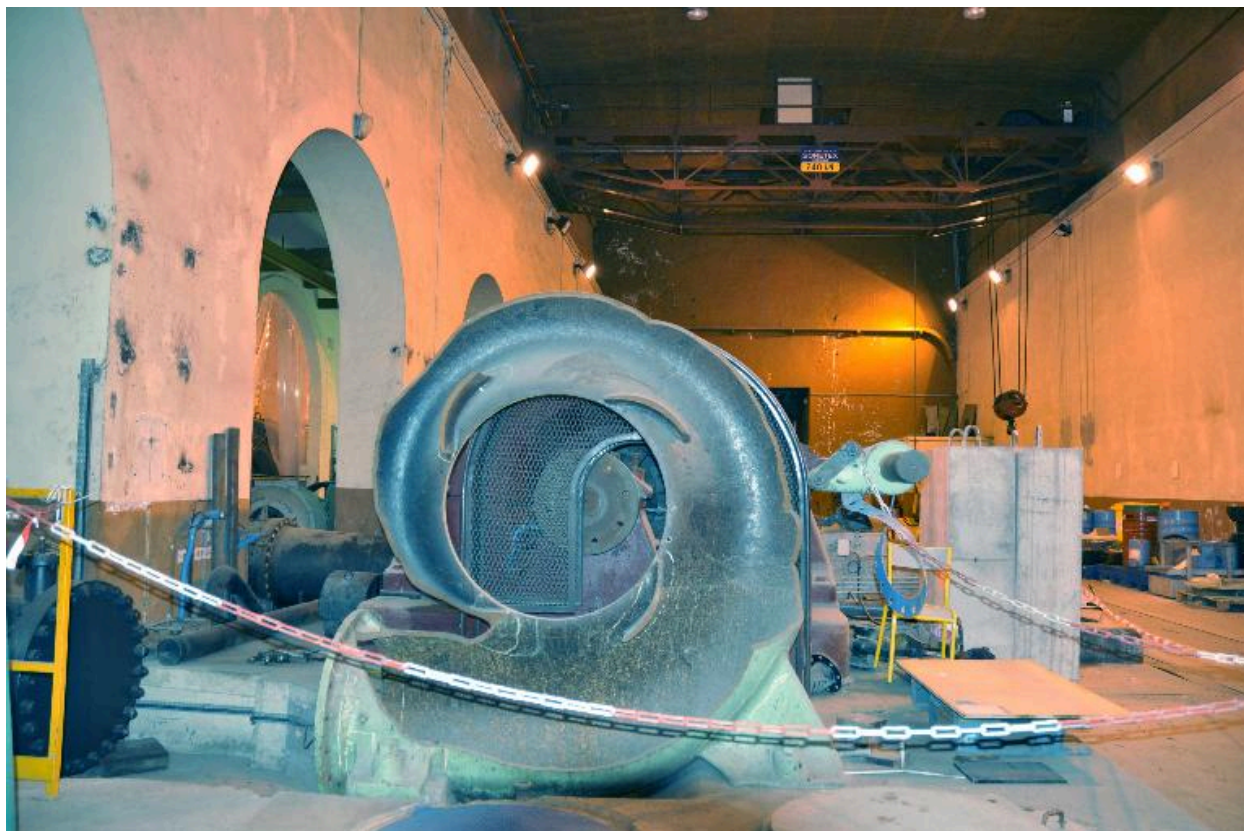
Détail de la bâche qui a explosée (centrale de Livet)
