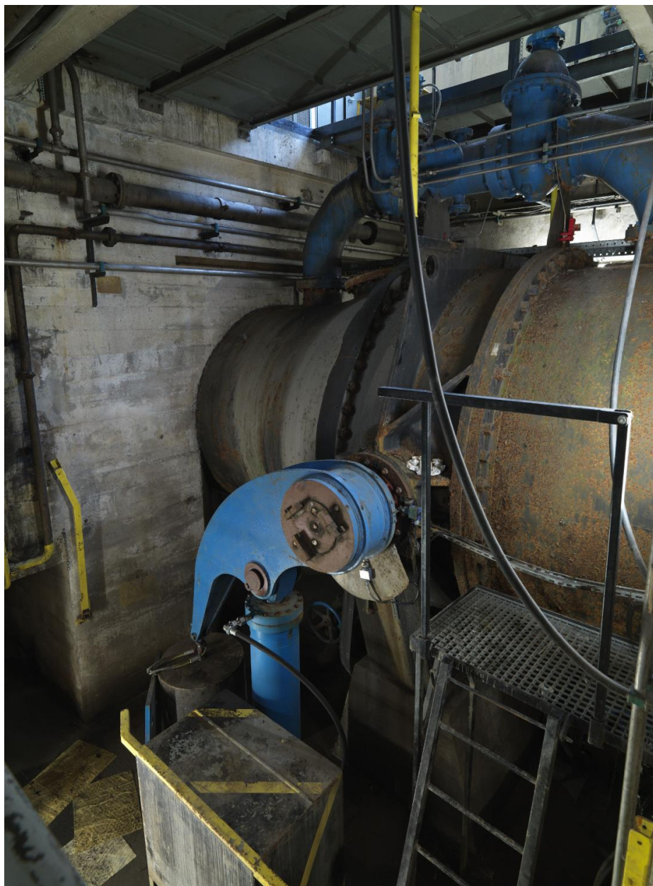
Vanne de pied du groupe 3 (en sous-sol)
