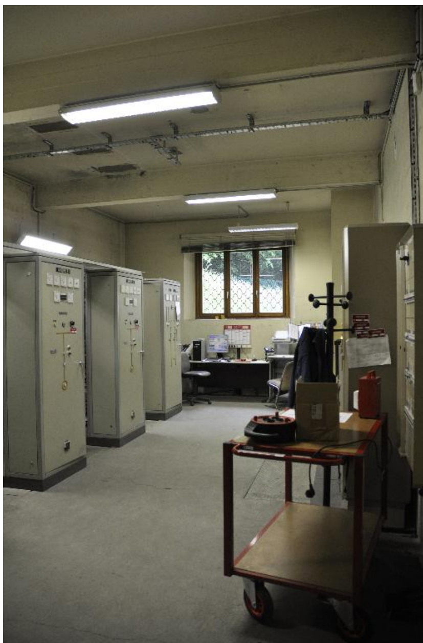
Vue de la salle des compteurs des groupes
