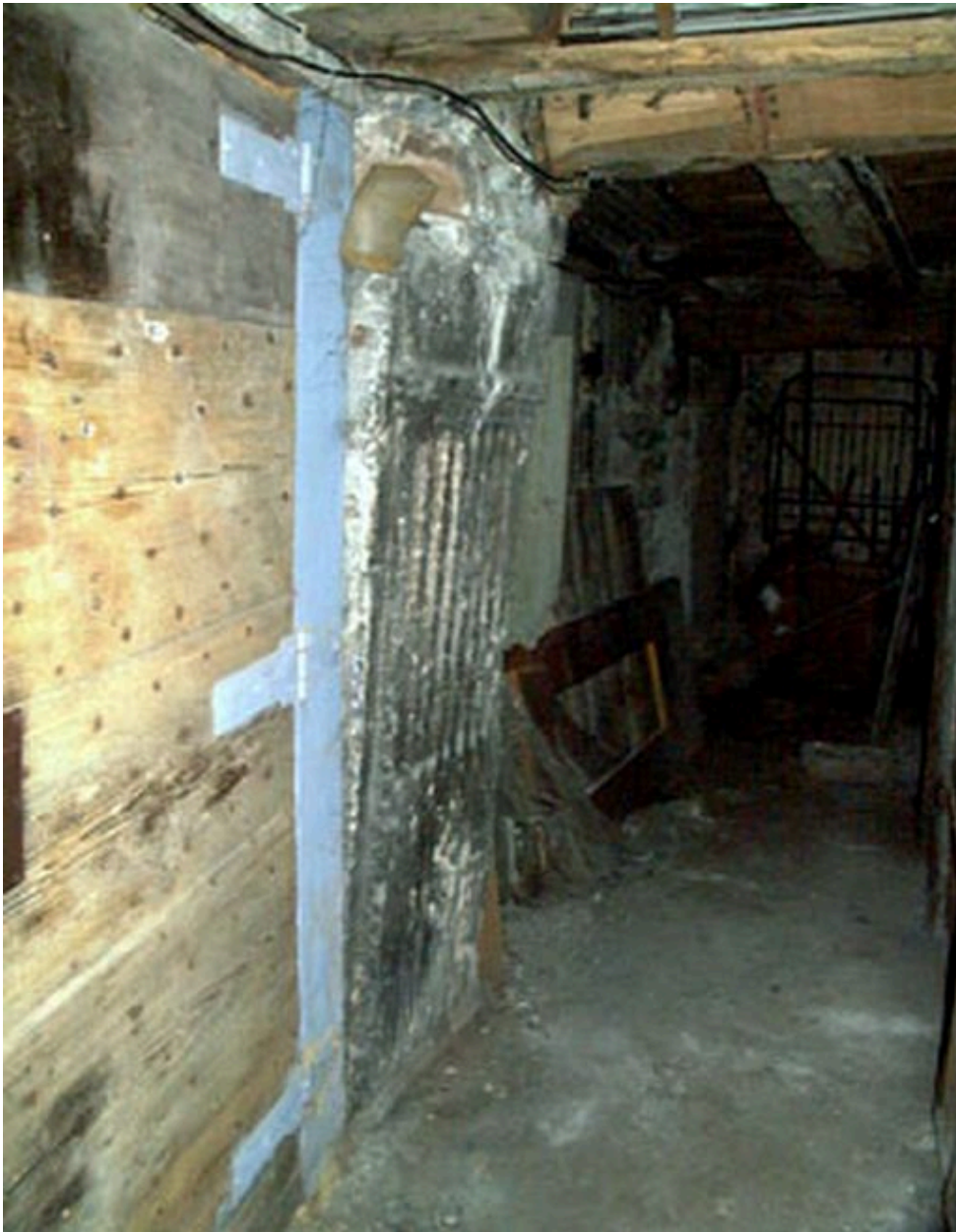
Vue d'un pilier en remploi au niveau des caves (vestiges de la maison Bellière ?)
