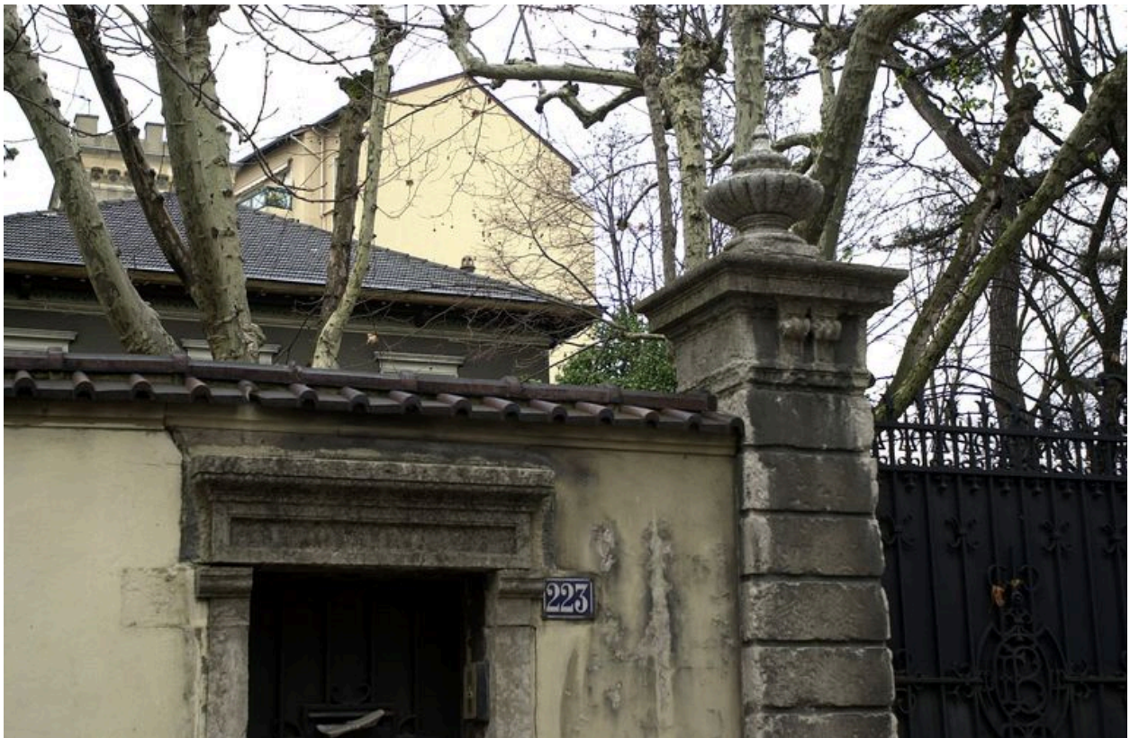
Détail du linteau de la porte piétonne et d'un pilier de la porte cochère
