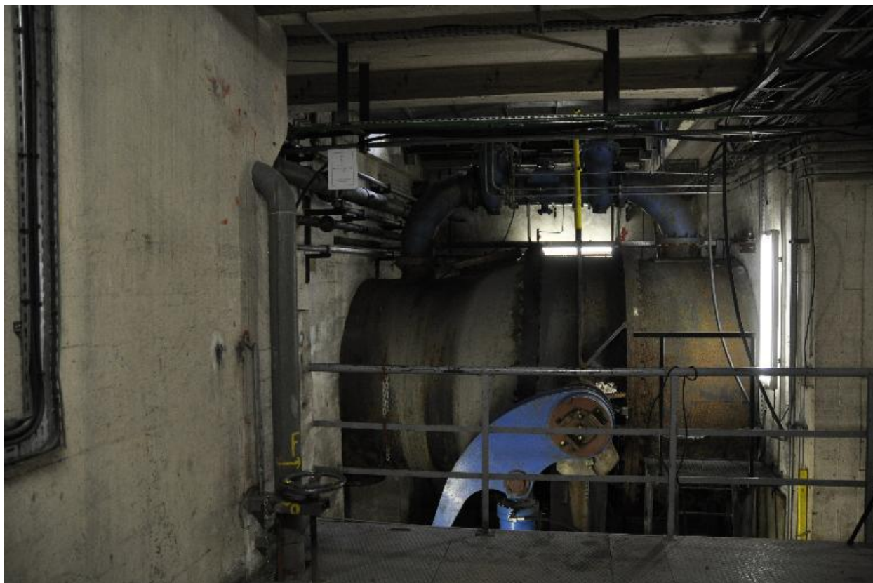
Vue des installations des groupes au sous-sol
