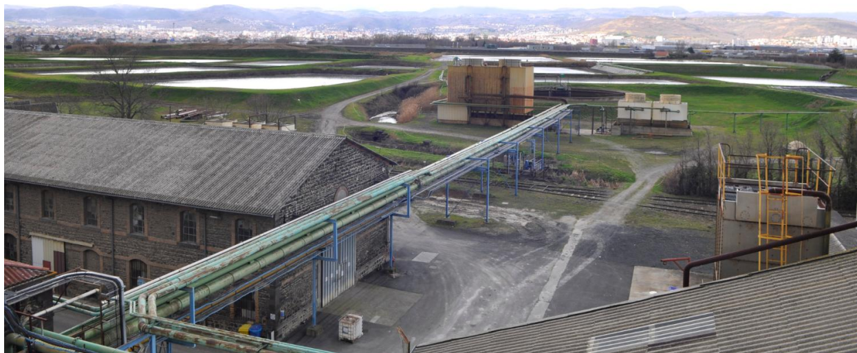
Vue extérieure : lagunage du traitement des eaux
